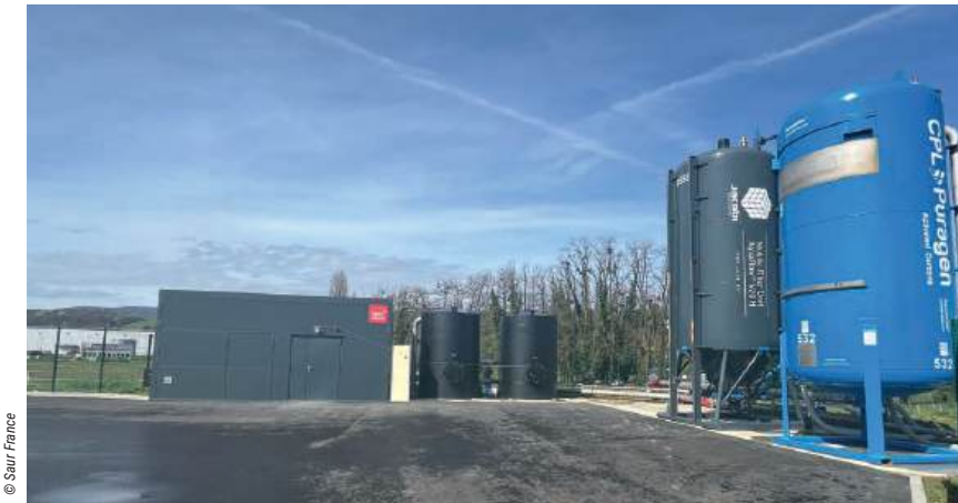
Unité Mobile de traitement des PFAS installée proposant une solution de filtres de charbon actif, sous forme de micro-grains.
