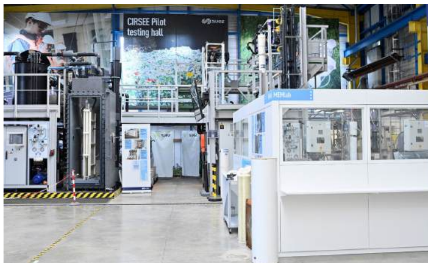
Plateforme MEMlab (performances des membranes d'ultrafiltration, nanofiltration et osmose inverse) du CIRSEE, à Croissy-sur-Seine.
