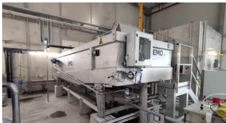
Unité de traitement d'effluents industriels FLOTTATEUR À AIR DISSOUS
