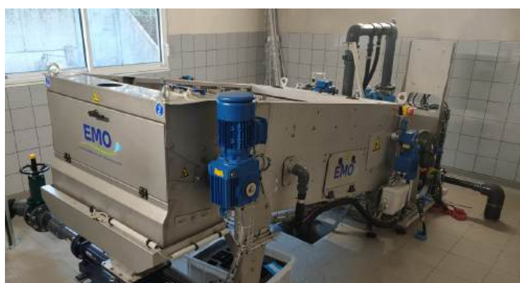
Unité d'épaississement de boues sur skid TABLE D'ÉGOUTTAGE
