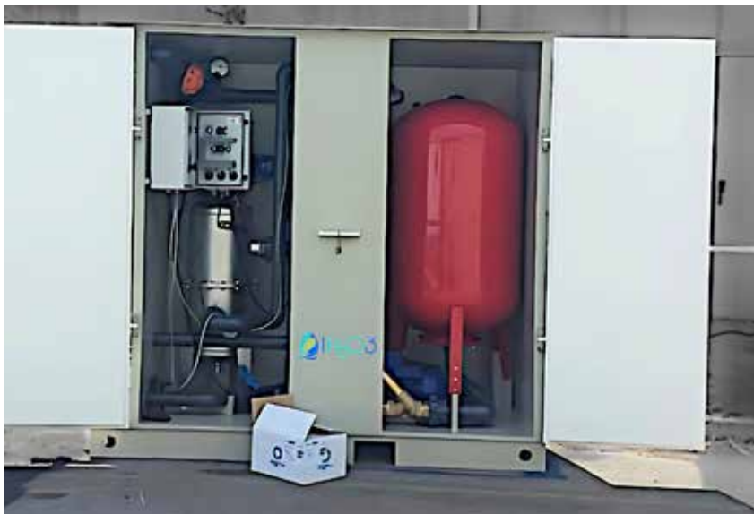
Skid REUT 1h2o3 installé en sortie d'une station d'épuration avec un pompage direct dans le clarificateur.
