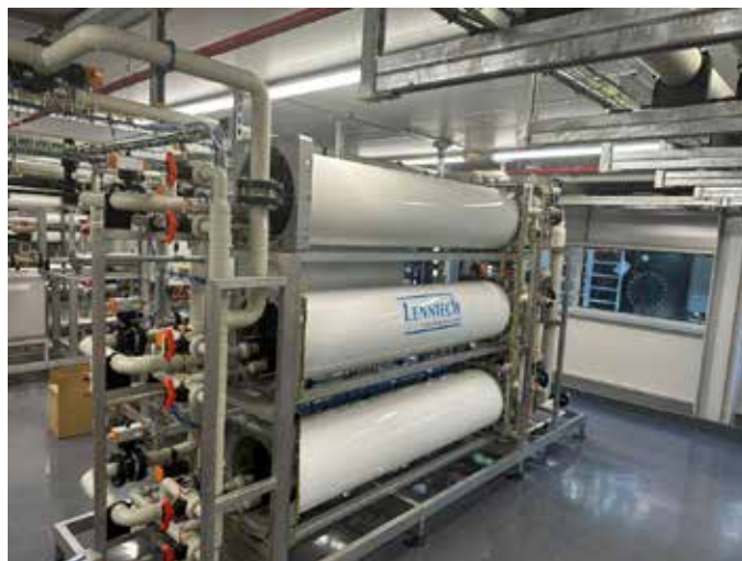
Figure 2 - Photo d'une installation dans une usine de semiconducteur pour production d'eau ultra pure - Technologies principales : RO+EDI – Hiver 2023, au Portugal
