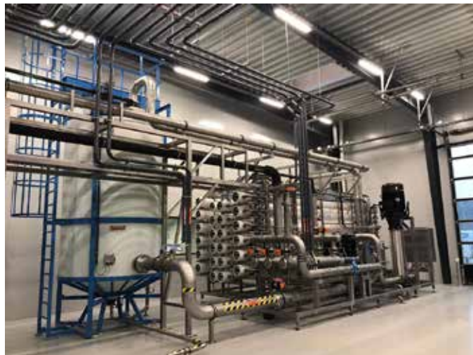
Figure 1 - Photo d'une installation dans une brasserie pour réutiliser jusqu'à 80% des eaux usées - Technologie principale : CCRO – Printemps 2021, au Danemark
