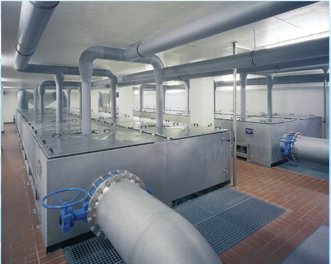
Installation des eaux potables de Bale – débit 1 400 m 3 /h
