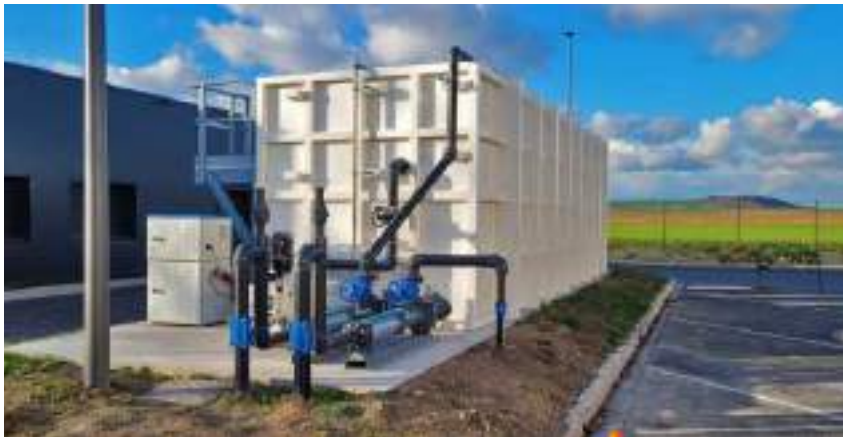
Traitement biologique Unibiocell Waste Water Box adapté pour les industriels.
