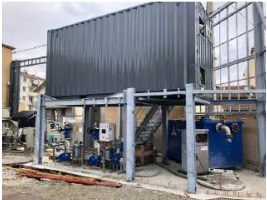
Système modulaire de coagulation-floculation-flottation, installé par ExoCell pour les besoins d'une chocolaterie.
