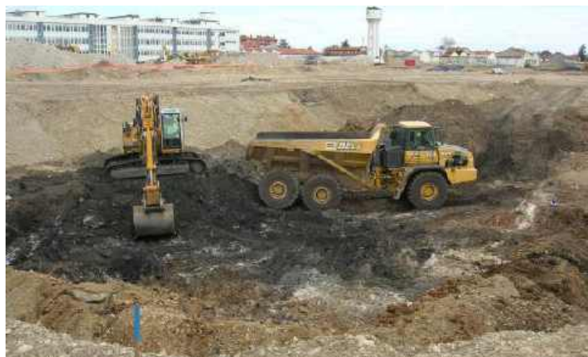
Excavation d'une pollution dans le cadre de la cessation des activités d'un site industriel et de son redéveloppement.
