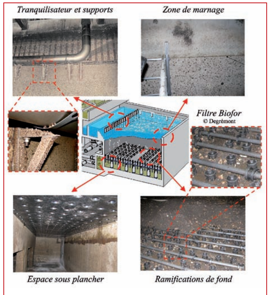
Figure 2 : État d'une cellule de filtration de type Biofor® et de ses équipements périphériques.
