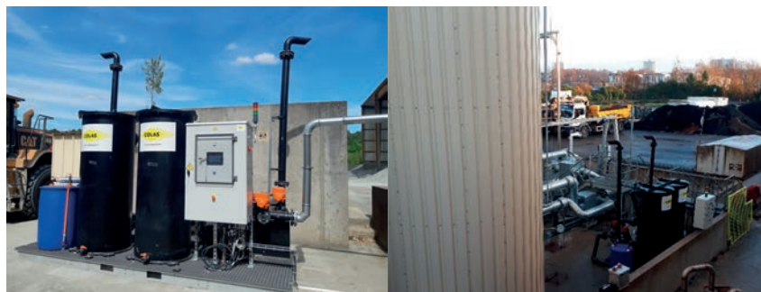
Figure 1 : Exemple de SKID de traitement.
