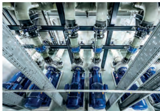
Circuit eau de mer. Pompes KSB Mega CPK 250-400 en acier anticorrosion Noridur®. Débit nominal: 720 m 3 /h. HMT nominale: 48 mCE.
