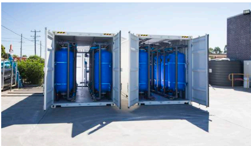
Unité conteneurisée de chez Lanxess pour le traitement des PFAS sur un site d'entraînement contre la lutte incendie en Australie. Le traitement complet consiste en une oxydation, ajustement de pH, séparation des solides, filtration puis résine échangeuses d'ion Lewatit.
