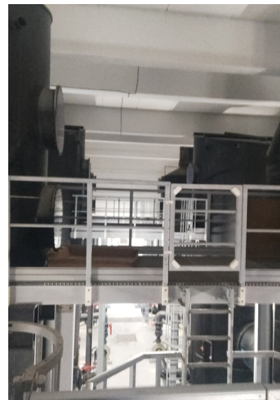
Installation d'une solution avec fourniture de charbon actif pour une STEP à Evreux par Micr'Eau.
